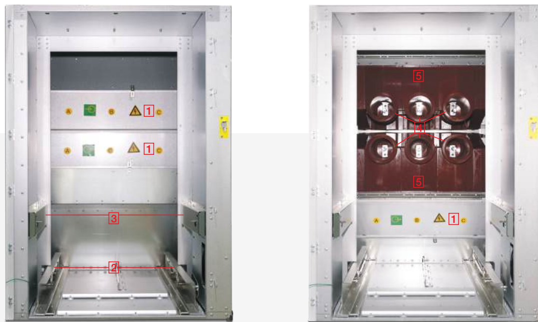
Khoang máy cắt/Circuit Breaker Compartment
